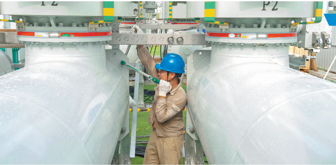
500千伏桃花港开关站
