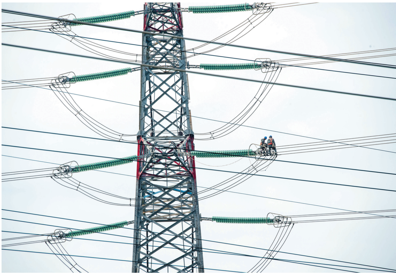
近日，在锡山区厚桥街道500千伏梅木线，工作人员对线路设备进行全面检修。国网无锡供电公司利用天气凉爽、用电量相对较低的有利时机，组织人员开展线路、变电站集中检修维护，保障电网安全稳定运行。（潘正光 摄）
