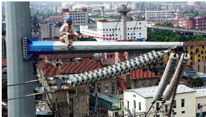
（无锡供电公司供图）
