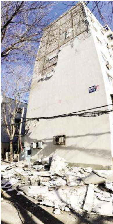
一幢居民楼外墙上的保温层被吹落在地。（新华社资料图）
