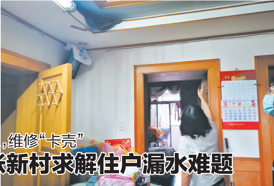
楼上漏水,楼下受牵连。
