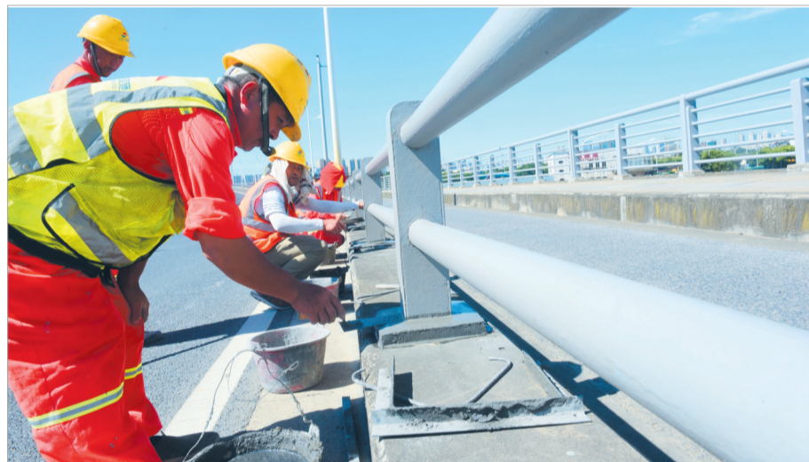
8月12日，在永旺大桥上，市政工人对桥梁进行养护作业。 （还月亮 摄）
