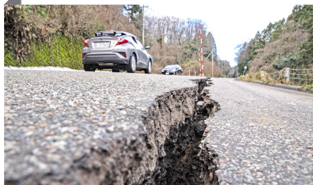
1月2日,在日本石川县羽咋郡,道路被地震损坏。(新华社)
