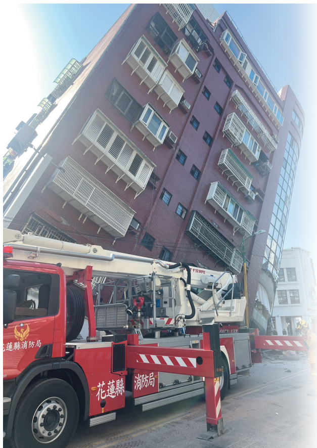
花莲县北滨街一栋公寓民宅大幅度倾斜。(新华社)
