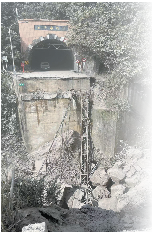
苏花公路大清水隧道外发生塌方。(新华社)
