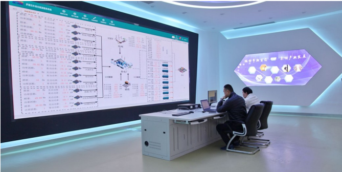
红豆综合能源管控平台大屏
