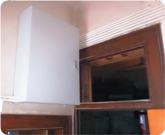
出租屋里安装的分电箱。
