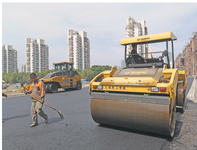
昨天，市政工人在稻香东路摊铺沥青。据悉，作为民生工程的稻香东路拓建工程已基本完工，预计本月底通车，大大方便周边居民出行。(陈大春 摄)
