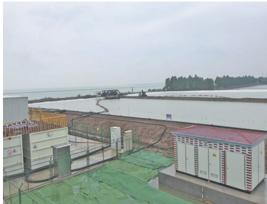
泥水分离池和缓冲池
