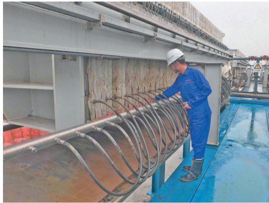
淤泥固化处理系统
