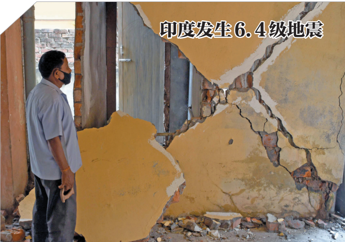
这是4月28日在印度阿萨姆邦高哈蒂拍摄的地震后开裂的墙壁。据印度国家地震中心28日测定,印度东北部阿萨姆邦当地时间28日7时51分发生6.4级地震。
