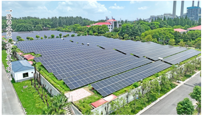
← 芦村污水处理厂光伏发电项目。
